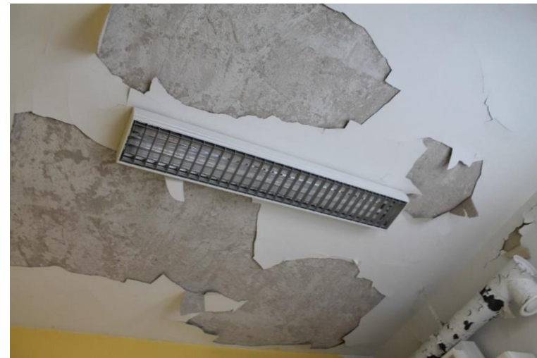
Kuva 121 Tilan 103 katosta on irtoillut suurin osa maalista.
