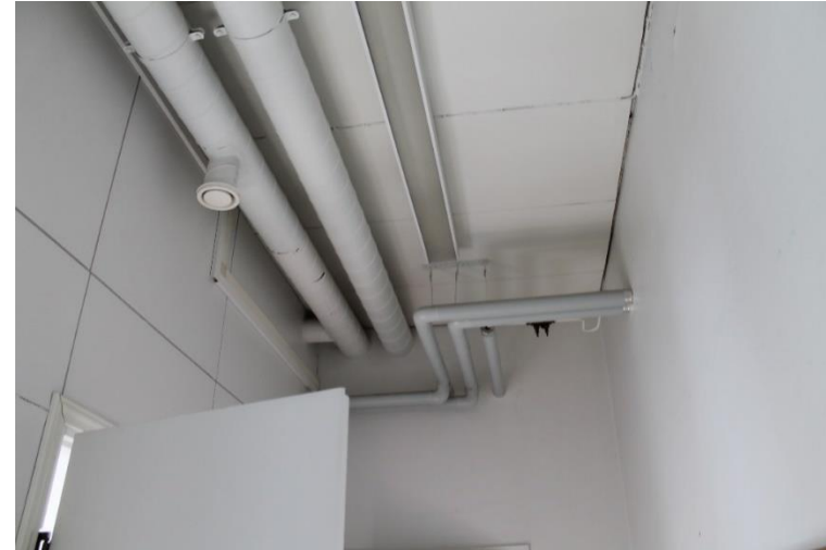
Kuva 188 Ilmanvaihtoputkia, vesijohtoja ja valaisimia.
