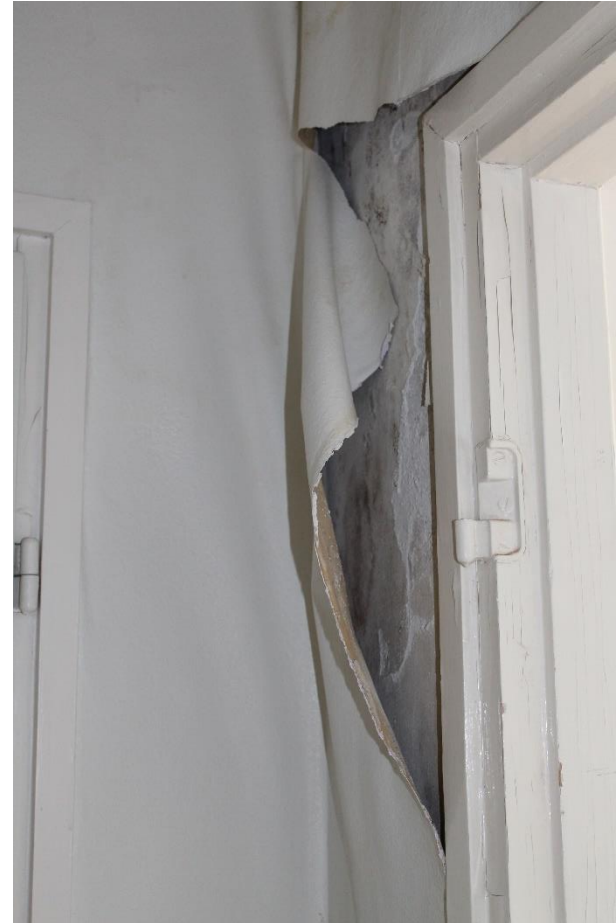
Kuva 242 Yläkerran tapetit ovat irttoilleet seinärungosta.
