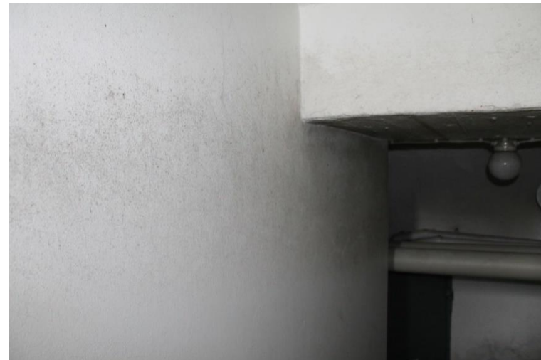
Kuva 283 Kellarin seinät ovat tummuneet porrashuoneessa.
