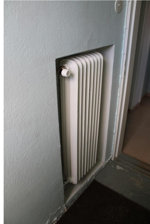
Kuva 115 Seinän sisään lovettu lämpöpatteri tuulikaapissa.
