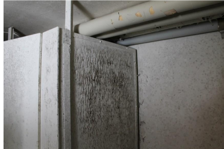
Kuva 265 WC-koppien ovet ovat tummuneet ja huoneen seinät ovat kauttaaltaan täynnä tummentumia.
