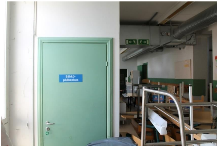
Kuva 167 Sähköpääkeskus ensimmäisen kerroksen käytävällä.
