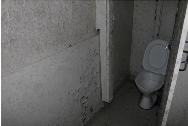
Kuva 267 Kuvan vasemmassa reunassa on seinässä oleva lämmityspatteri ja oikealla vessakoppi.
