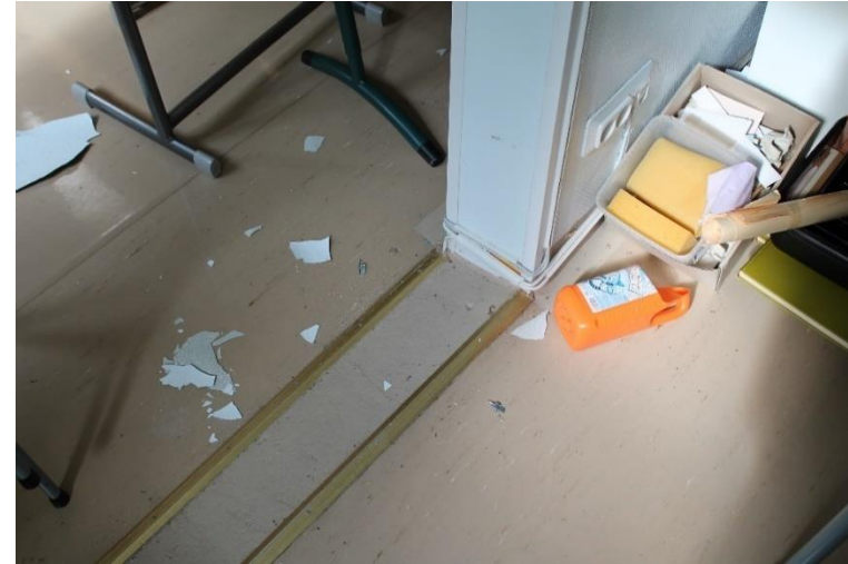
Kuva 111 Jälkeen päin puhkottu kulkuaukko näkyy mm. muovimattojen listoituksissa.
