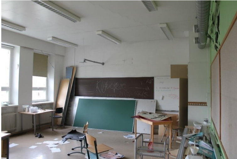
Kuva 158 Luokkahuoneen 111 katossa on useita pinta-asennettuja suorakulmaisia kattovalaisimia.
