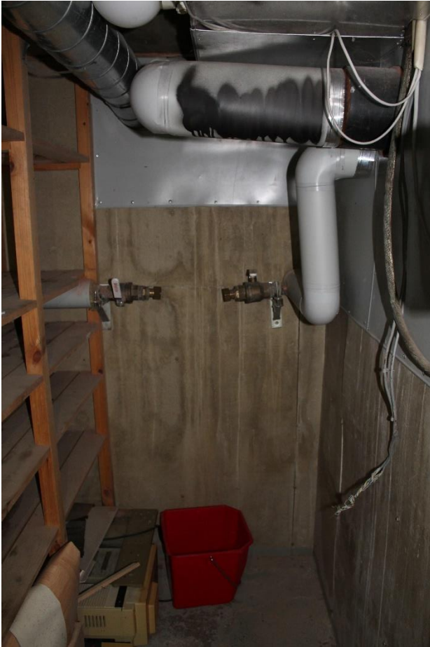
Kuva 290 Vesijohtojen sulkuventtiilejä kellarissa.
