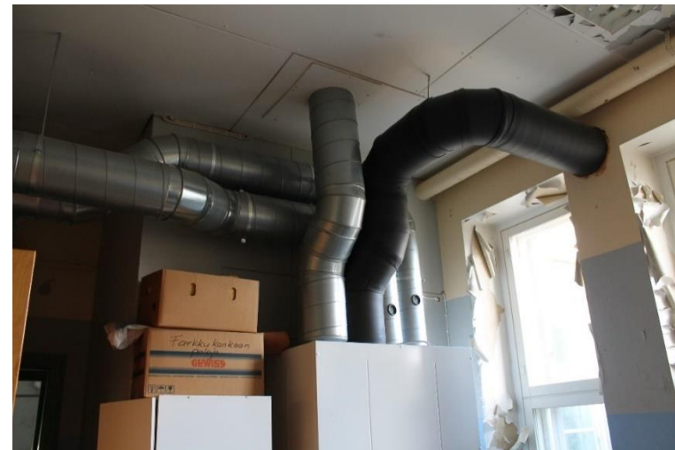
Kuva 195 Vanhassa opetusvälinevarastossa on esillä monia ilmanvaihtoputkia. Huoneen seinät on maalattu kolmella eri värillä; sinisellä, harmaalla ja keltaisella.
