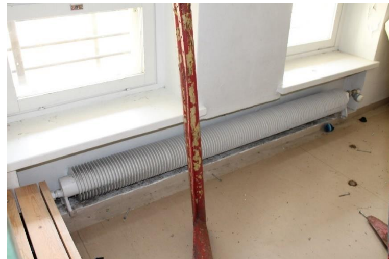
Kuva 165 Käytävällä sijaitsevan vaatetilan yhteydessä on sylinterimäinen lämpöpatteri.
