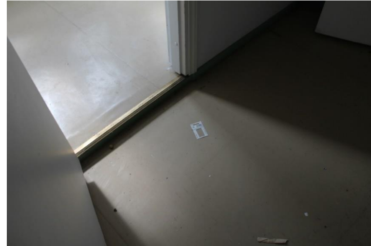
Kuva 180 Kynnys eteistilassa. Pesuhuoneen lattiataso on korkeammalla kuin eteisen.
