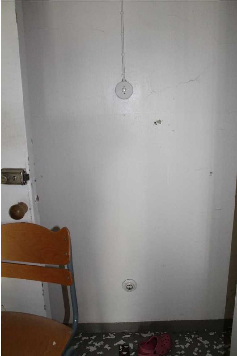
Kuva 225 Yläkerran seinissä on paikoin pinta-asennettuja sähkökytkentöjä.
