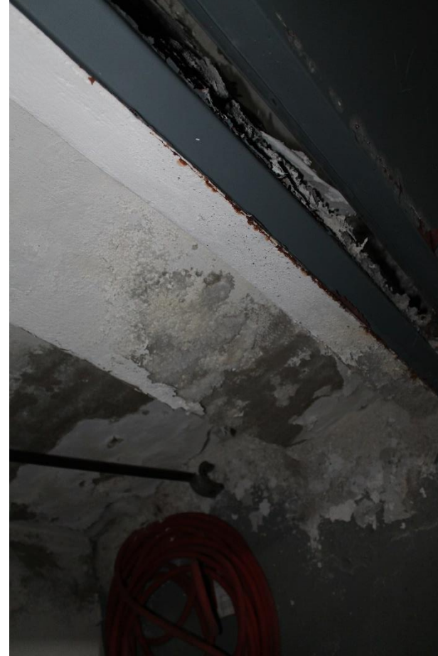
Kuva 287 Mikrobikasvustoa kellarin seinässä.
