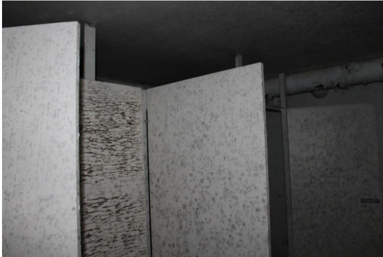
Kuva 280 Vessakoppien seinät ovat tummuneet.
