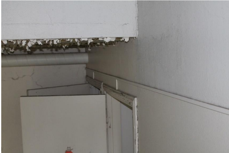
Kuva 260 Sähköjohdot kulkevat seinillä vanhoihin opettajanasuntoihin ohutta pinta-asennettua kiskoa pitkin.
