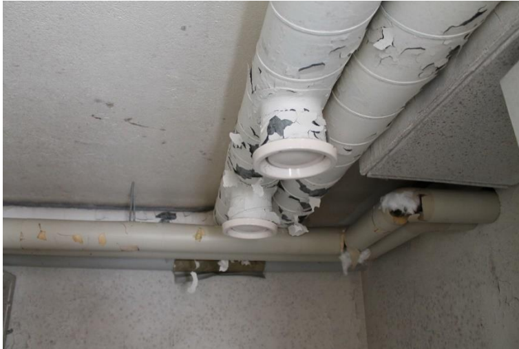
Kuva 263 Poikien vessan ilmanvaihtoputkia.
