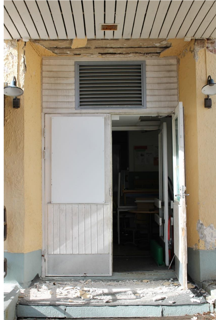
Kuva 67 Pääsisäänkäynti. Ikkunat ovissa on tukittu.
