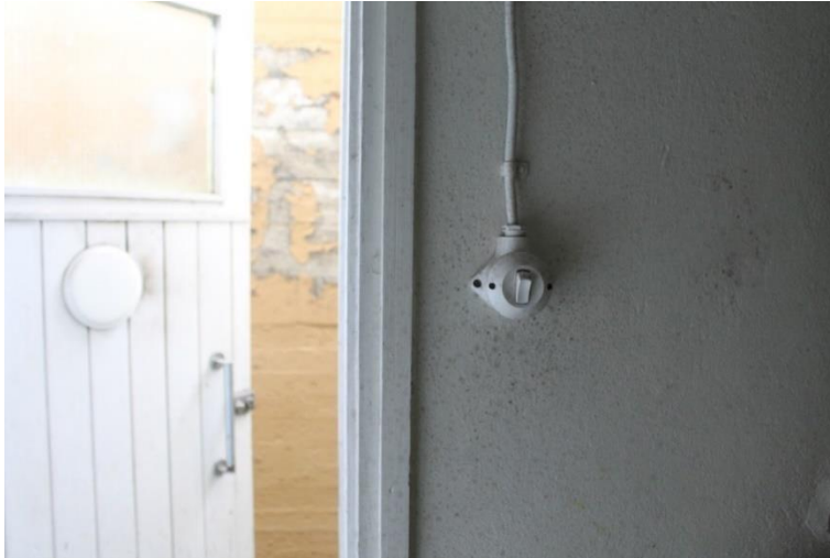
Kuva 274 Valokatkaisin tyttöjen saniteettitiloissa.
