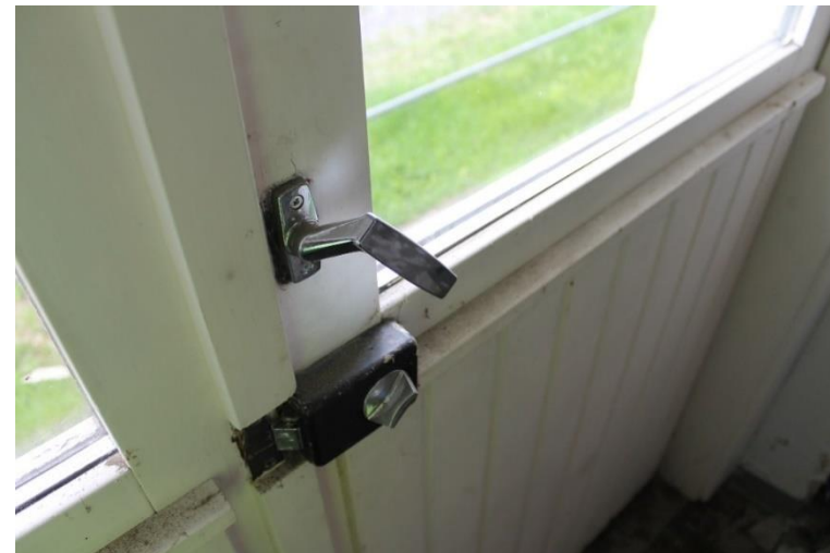
Kuva 142 Lounaan puoleisen takaoven kahva ja lukko. Ovi on uusittu.
