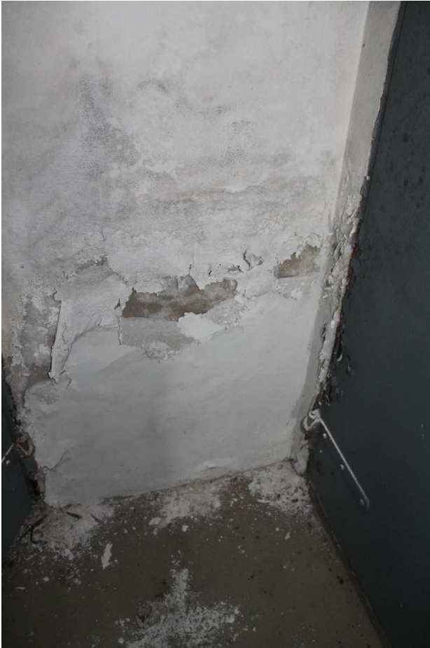
Kuva 284 Kellarinseinien runsas mikrobikasvusto on hajun lisäksi aistittavissa silmällä.
