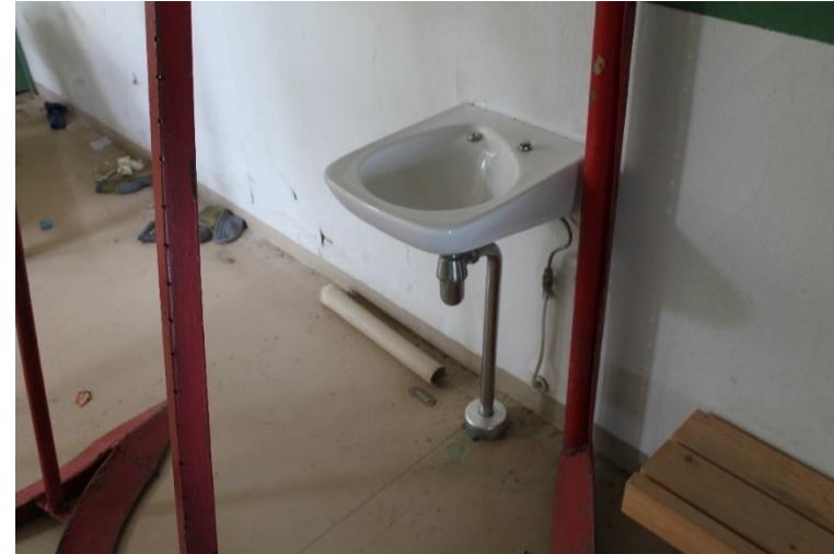
Kuva 164 Käytävällä sijaitseva vesipiste.
